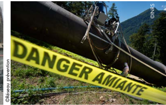
Ponçage d'une conduite forcée revêtue de peinture bitumineuse amiantée avec un robot équipé d'un dispositif d'aspiration des poussières à la source
