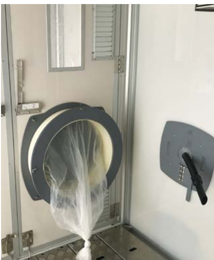
Vue depuis le compartiment propre : dispositif d'ensachage en continu des déchets, aération dotée d'un dispositif anti-retour (ventelles), fenêtre de visualisation, passage pour tuyau d'un aspirateur THE
