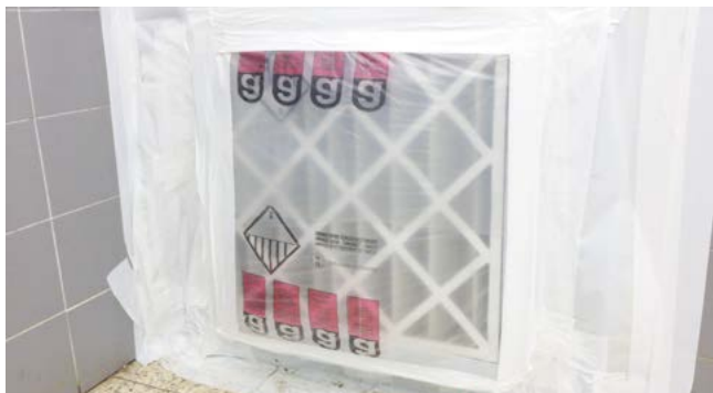
Visualisation de l'effet de gonflement (polyane gonflé) lié au maintien à l'arrêt de l'extracteur de secours, générant un risque grave de décolmatage des filtres dans la zone lors des vérifications avant le démarrage du chantier.
